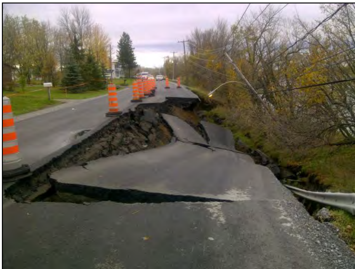
FIGURE 2. PHOTOGRAPHIE DU RÉSULTAT DU GLISSEMENT DE TERRAIN (MTQ, 2011)
